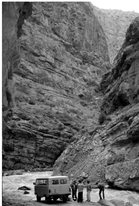
Fig.5. Gorge du Sherabad-darya au nord de Derbent: la route emportée par les crues du printemps avec, au fond, les vestiges de la carcasse de troncs constituant le support du parapet de pierres (mai 1997) (vu du sud)
