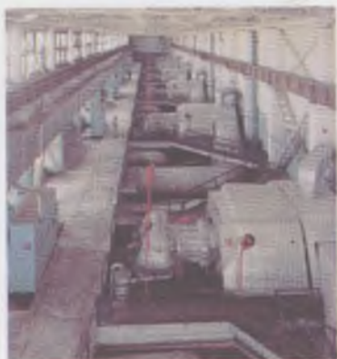
Хивинская газокompрессорная станция.
