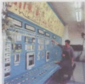
Навоийский электрохимический комбинат.
