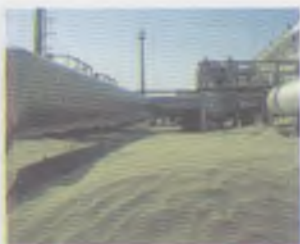
Газопровод компрессорной станции.
